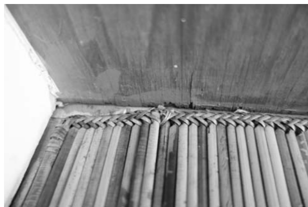
損傷箇所 小上がり 敷物縁の角がぼつれている
